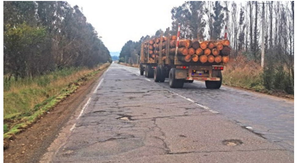
La Ruta R-86 presenta un severo daño en su calzada producto de enormes baches en la vía, transformándose en un riesgo para los conductores.
