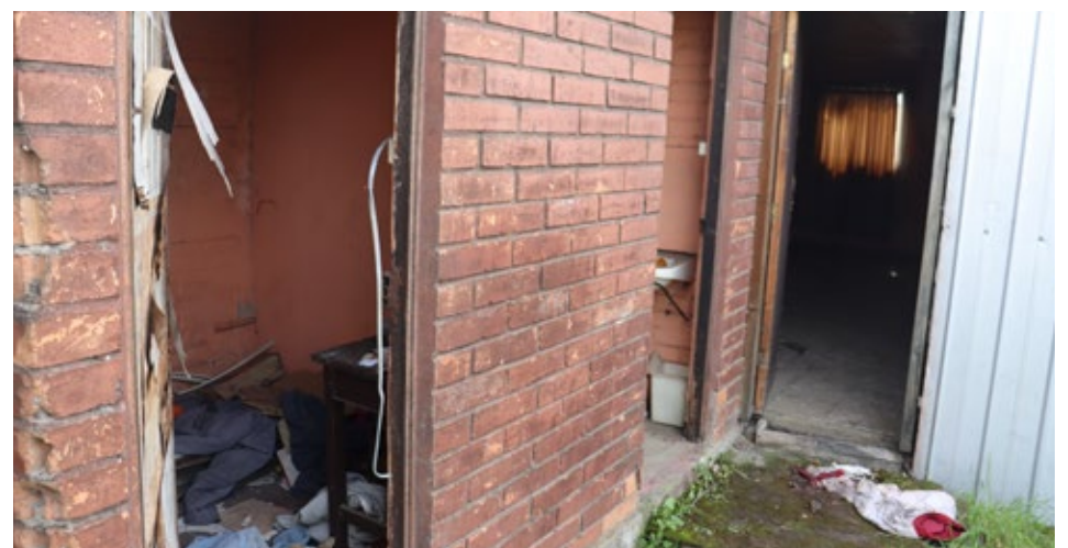
El inmueble en su interior acumula basuras y tiene daños.
