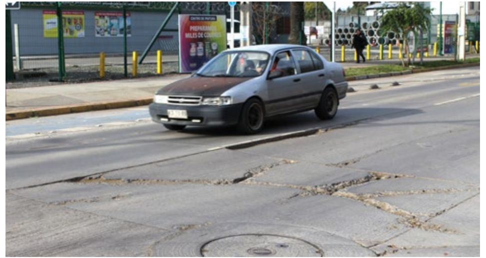
El pavimento quebrado en Dillman Bullock con Yeli, en Huequén, está muy deteriorado.
