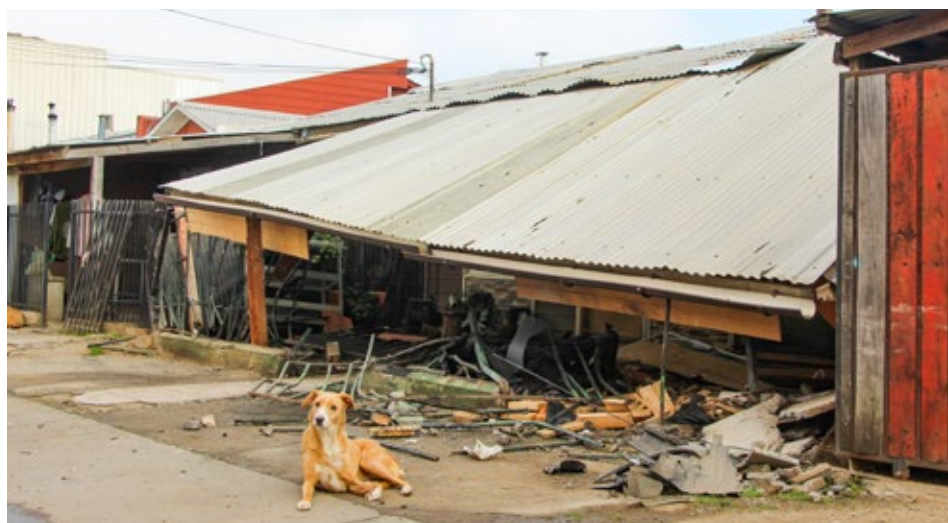
La casa en la Villa Las Naciones quedó con daños de consideración tras ser colisionada por una automóvil la madrugada del viernes.
