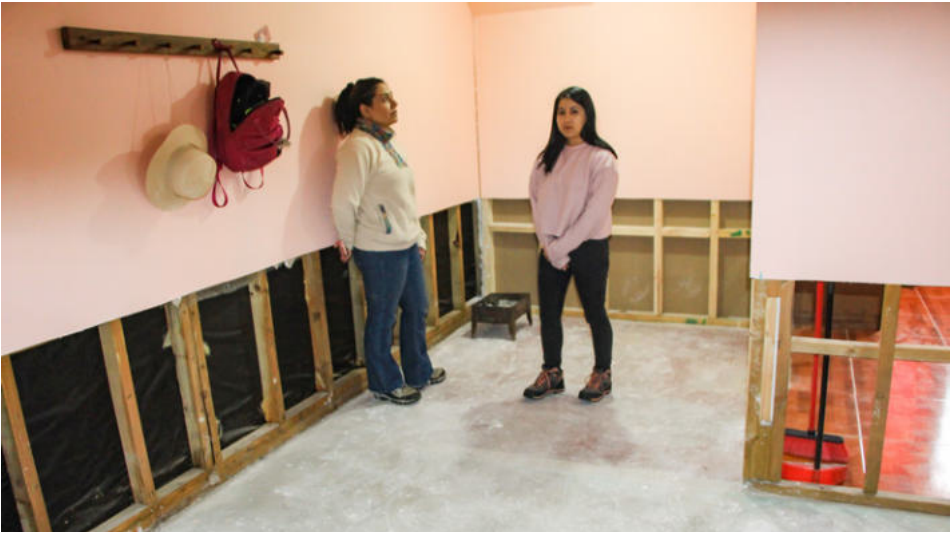
El eventual traslado de las familias afectadas por las inundaciones continúa en fase de planificación y, de acuerdo con los plazos entregados por Vivienda, las primeras soluciones podrían concretarse recién a partir de 2029.
