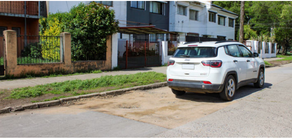
En calle Bilbao, a la altura del número 150, a media cuadra del estadio, los conductores deben maniobrar para evitar daños en sus vehículos.
