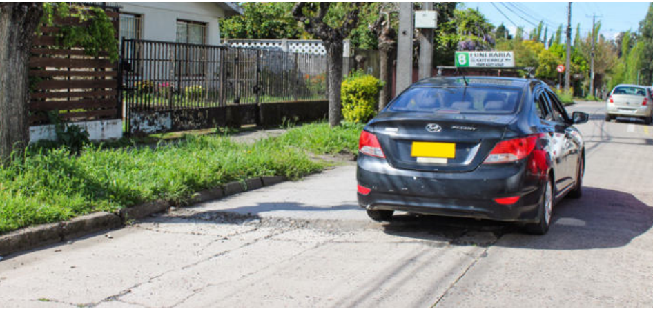
En calle Cautín, frente al número 658, cerca del Cefsam Piedra del Águila, el cemento se está levantando y deteriorando la calzada.
