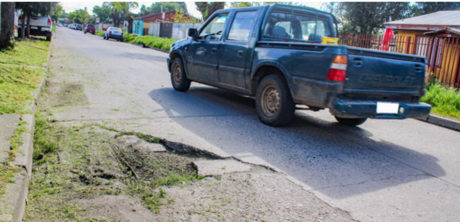
En Chacabuco con Las Heras, frente a la panadería La Real, el cemento se partió y dejó un forado de grandes dimensiones junto a la acera.
